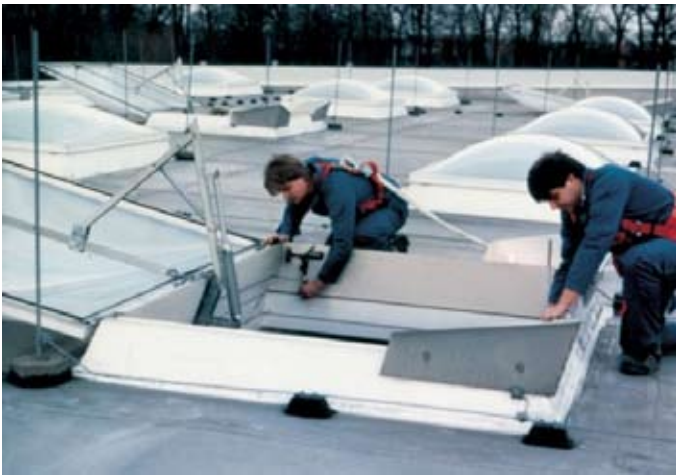
Abbildung 2: Hohes Gefährdungspotenzial bei späteren Arbeiten an Lichtkuppeln Quelle: Thomas Rüschemschmidt
